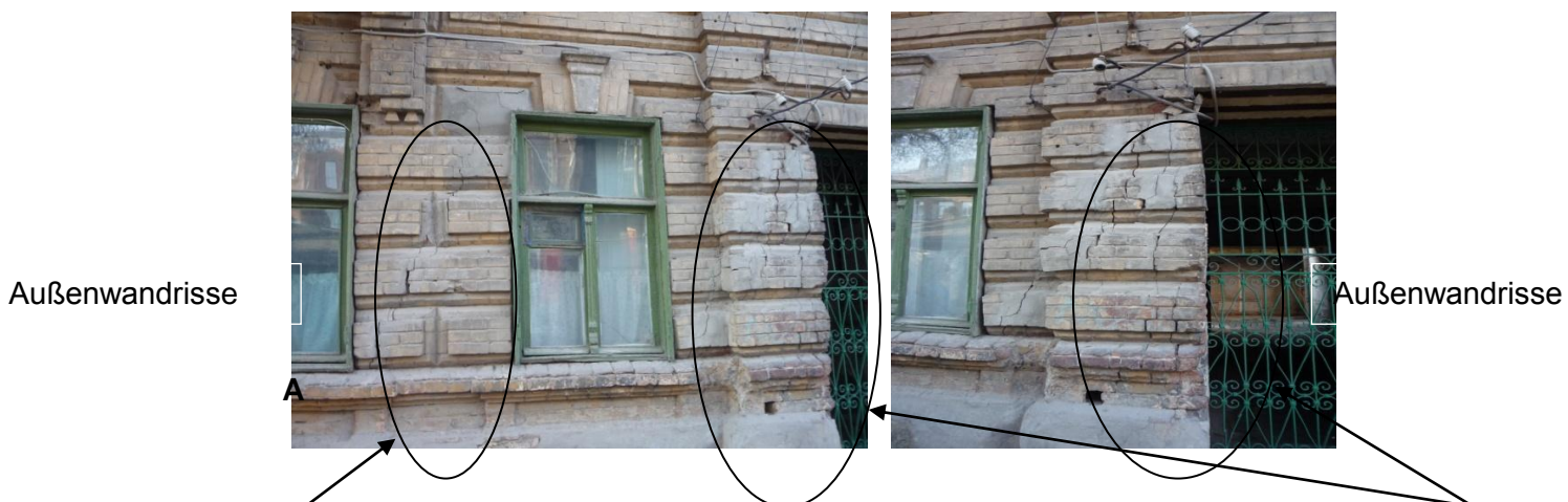
Abbildung 27: Risse auf den Außenwänden infolge überschüssiger Feuchte in Kellerbereich, Temernitskaya Str., 89, Rostow-on-Don
