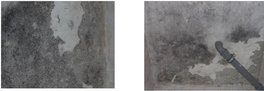
Abbildung 24: Schimmelpilzbefall auf der Geschosdecke eines Badezimmers in der Wohngemeinschaft in Russland
