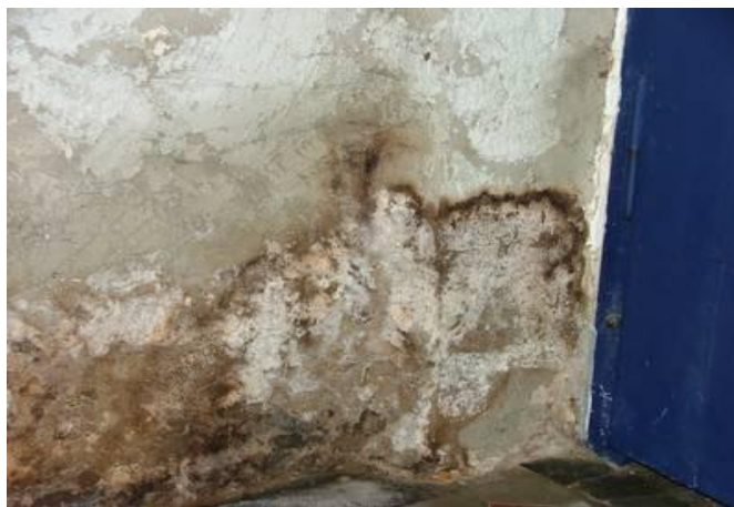
Abbildung 31: Tauwassererscheinungen an der Innenwand
