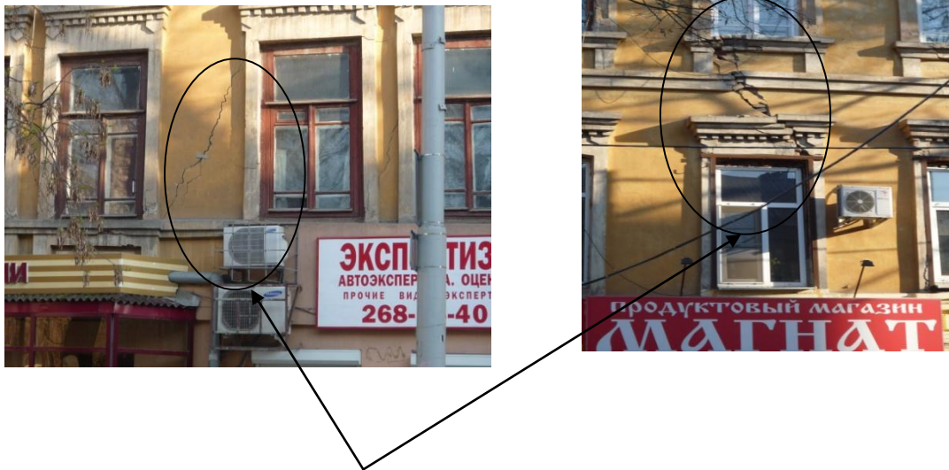
Schiefe Außenwandrisse auf der Hauptfassade
